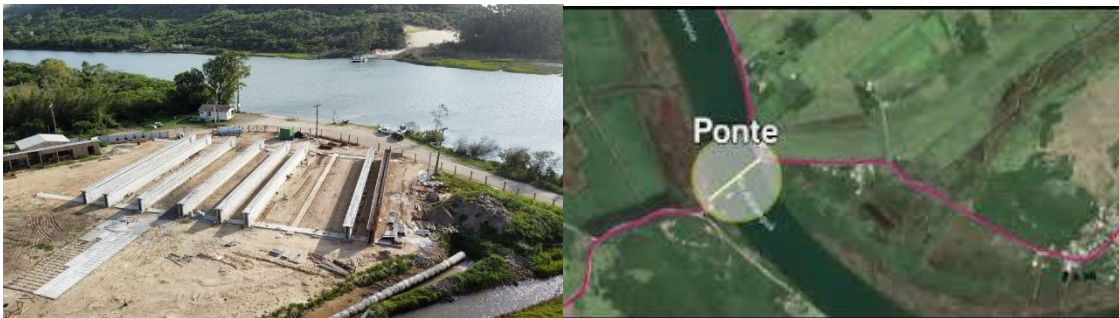
Figura 47 (trecho 2): Obras da ponte do rio Araranguá, na altura da atual passagem da balsa.
